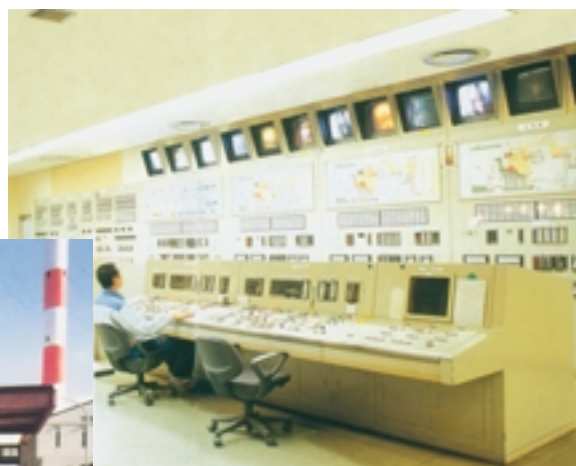
高浜クリーンセンター・中央制御室
